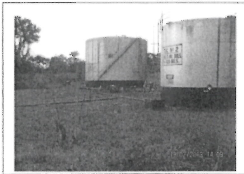
Descripción: Vista de los Tanques 1 y 2 (Puerto Oriente), obsérvese presencia de suelo y vegetación en la zona de estanca
