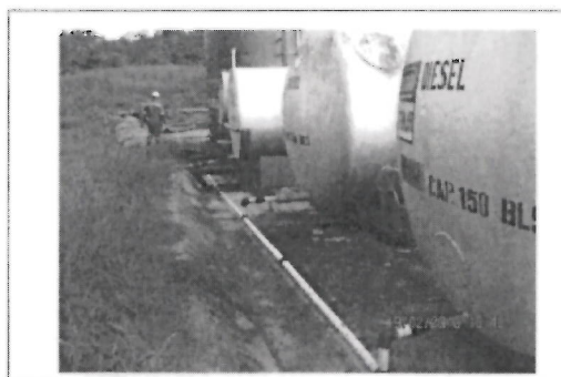
Descripción: Vista del Área de Almacenamiento de Combustible para consumo directo – Puerto Oriente, observese presencia de vegetación y las juntas de dilatación sin impermeabilizar.
