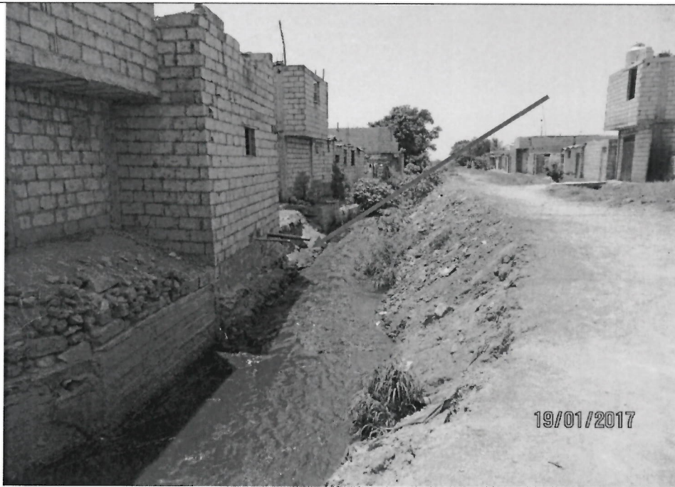
Fotografía N°15: Estos efluentes líquidos continúan su recorrido por el canal de riego para ingresar a zonas de cultivo de caña. Se observa la descarga de efluente domestico de las viviendas que colindan el canal.
