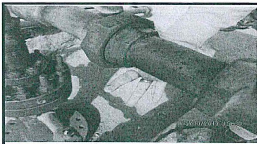
Fotografía N° 24: Pozo 1556, presenta liqueo en la "T" que conecta el puente de producción y copa (488413E, 9540469N)
