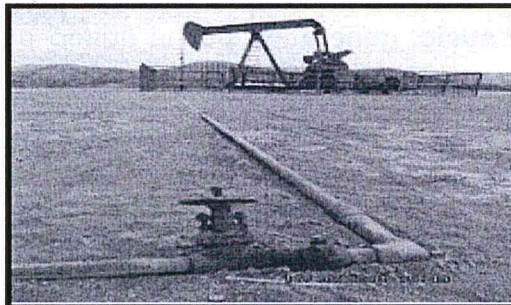
Fotografía N° 28: Pozo 5979, válvula presenta lquero (488546E, 9538452N)
