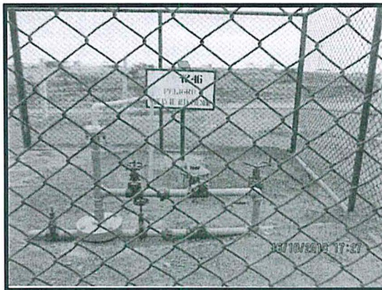
Fotografía N° 18: Pozo 1246, tipo gas lift, no presenta cantina ni geomembrana en el sector del puente de producción (487370E, 9539009N)
