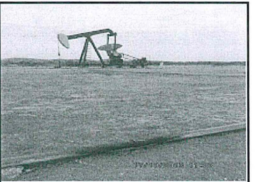
Fotografía N° 48: Pozo 8639, líquido en cable en línea de flujo a 15 metros del pozo (489127E, 9540144N)
