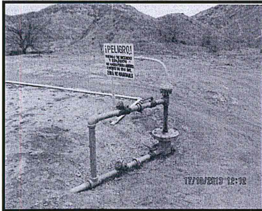
Fotografía N° 22: Pozo PB91, tipo gas lift, no presenta cantina ni geomembrana en el sector del puente de producción (486927E, 9537178N)
