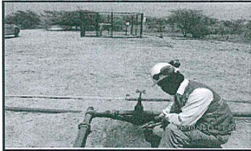
Fotografía N° 40: Pozo 1314, tipo gas lift, presenta cables humedecidos y válvula a 10 metros tiene líquida y tierra contaminada (491122E, 9536280N)
