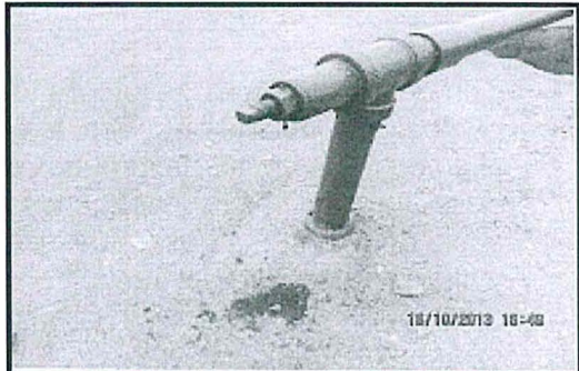
Fotografía N° 44: Pozo 6896, líquido fuera de la cantina (488830E, 9539877N)
