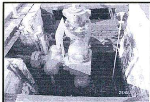
Fotografía N° 6: Vista del Pozo 63X de la Plataforma 60X. Obsérvese a la cantina, madera, suelos, bridas afectadas o impregnadas con hidrocarburo.
