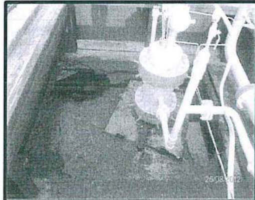
Fotografía N° 61: Vista de suelos y aguas afectados con hidrocarburos, (...) en el Pozo 118D de la Plataforma 107 del Yacimiento Corrientes.
