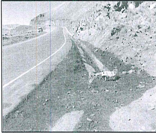
Fotografía N° 2 (17/08/2012): Suelo natural impregnado con hidrocarburos en la zona del derrame, km 241, carretera Juliaca – Arequipa.
