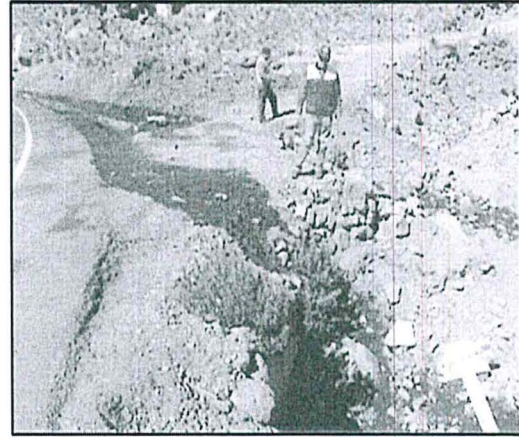
Fotografía N° 3 (17/08/2012): Afloramiento de hidrocarburos impregnado en el suelo natural cercano al riachuelo Ventilla.
