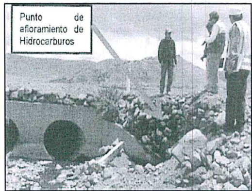
Fotografía N° 16 (24/10/2012): Afloramiento de hidrocarburos en la zona aledaña a la primera alcantarilla del riachuelo Ventilla. Ubicado en las coordenadas UTM WGS 84 N/8264964 E/331885.
