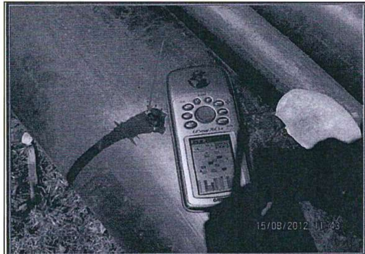
FOTOGRAFIA N° 50.- Observación N° 10: Se observa la tubería de conducción del agua decantada del depósito de relaves N° 5, que presenta un tarugo que cubre el orificio que funciona como estructura rompe-presión y que al desprenderse descarga el flujo de agua a su entorno inmediato constituido por zonas de pastura.
