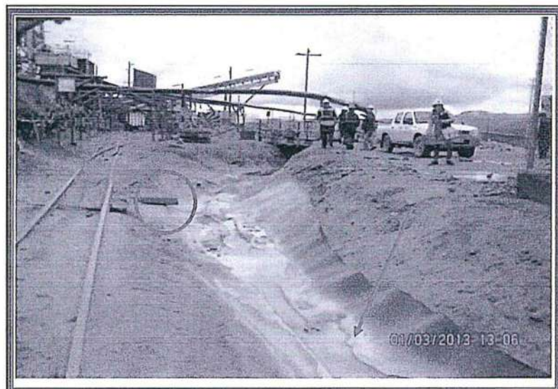
FOTOGRAFÍA N° 13.- Otra parte del canal que conduce las aguas de mina proveniente de la bocamina Nivel 500 Norte – El Poderoso, está cubierta con geomembrana; sin embargo, esta no se encuentra bien anclada en ambos lados del canal. Asimismo, se aprecia que el volumen de agua de mina es inferior, al volumen de agua de mina que se aprecian en las fotografías N° 11 y 12. Por otro lado, existe una tubería de metal que está dirigido al canal que conduce el agua de mina, el cual no presentaba descarga durante la inspección fiscal.
