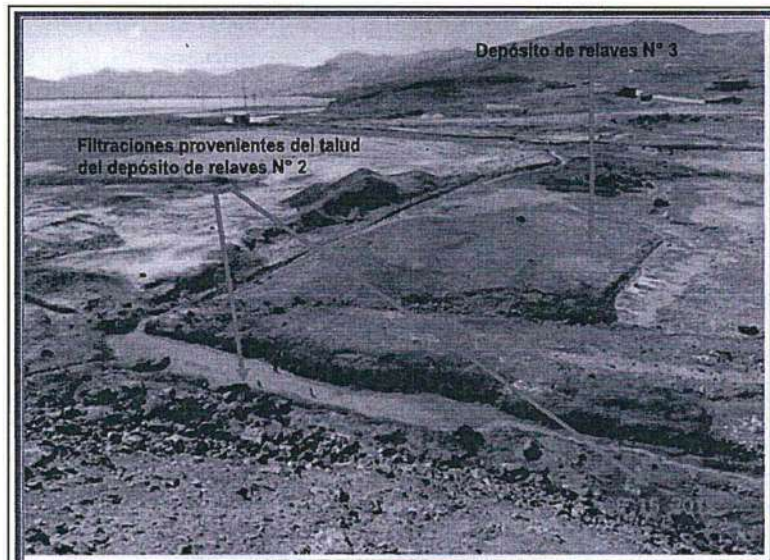
FOTOGRAFIA N° 36.- Observación N° 7: En el depósito de relaves N° 3, se ha identificado filtración proveniente de los depósitos de relaves N° 1 y 2.
