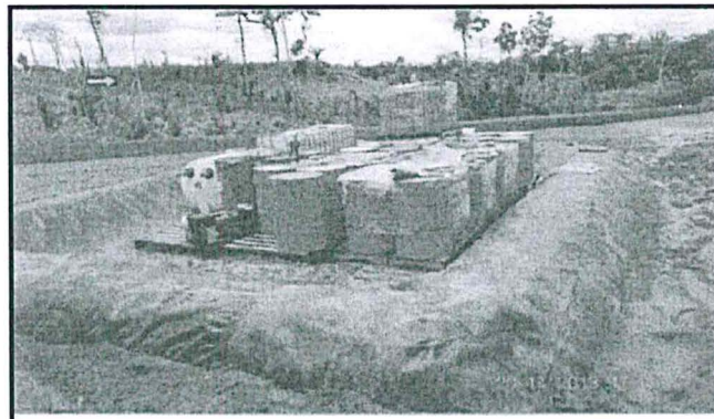
Fotografía N° 5: En el Almacén de aceites y Grasas, se observó falta de techo
