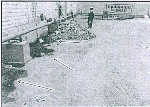
Fotografía N° 27 Área destinada para almacenamiento de residuos de construcción, se observa residuos sólidos metálicos apilados a lo largo de la pared límite de la planta envasadora.
