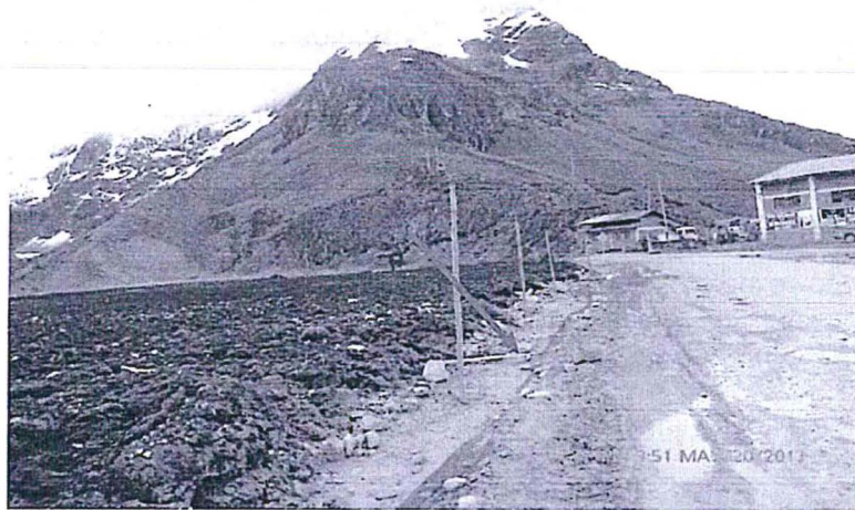
FOTO N° 93: Incumplimiento de Recomendación N° 17, 2011: Otra vista de la parte superior del botadero de desmonte El Polvorín, donde se vienen realizando trabajos de remediación como parte del Plan de Cierre. No cuenta con canales de coronación para las aguas de escorrentía.
