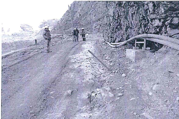
FOTO N° 76: Incumplimiento de Recomendación N° 3, 2011: La vía de acceso del túnel Santa Ana hacia la plataforma de almacenamiento de minerales de la Planta Concentradora no cuenta con cunetas para las aguas de escorrentía.
