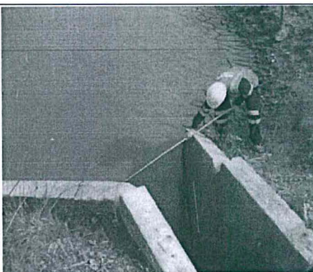
Fotografía N° 9.- Proceso de toma de muestra de lodos para su análisis, la huella de lodo existente en la pared de concreto de la compuerta nos indica el nivel anterior antes de la fuga del lodo.
