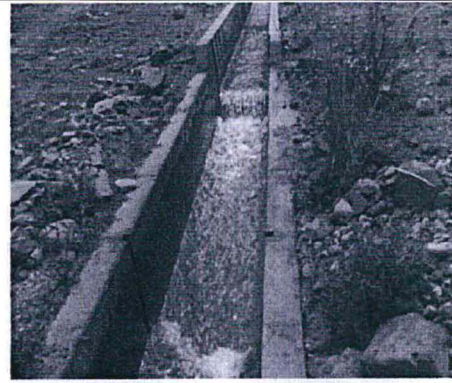
Fotografía N° 11.- Canal de descarga del efluente de la planta de tratamiento de aguas "Palcas" (tramo entre el canal de entrega de la poza de lodos y el punto EJ-17) no se observa sedimentos ni lodos
