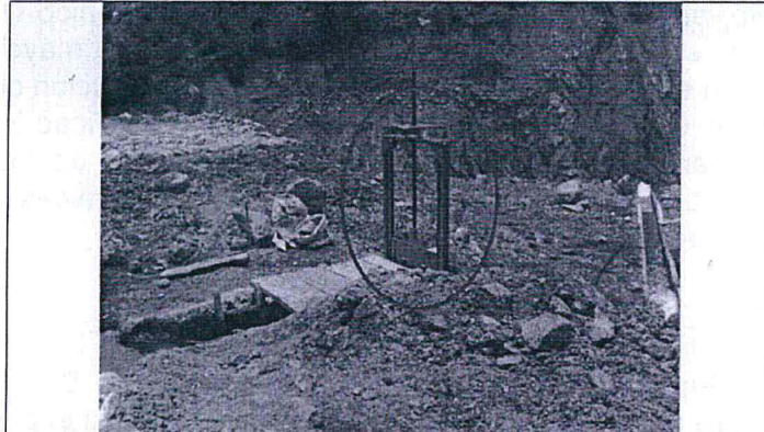
Fotografía N° 07: Vista de la compuerta metálica (círculo rojo) que controla rebose de efluente sedimentado en la poza de lodos N° 2 que estaba siendo utilizado como sedimentador
