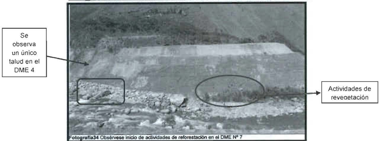
Fotografía N° 34 del Informe de Supervisión N° 196-2014-OEFA/DS-ELE
