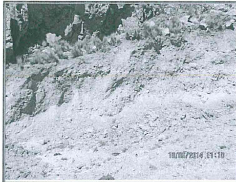
FOTOGRAFÍA N° 39.- Plataforma SMA-04 (8304711N-792343E), Plataforma no remediada y con huellas de erosión.
