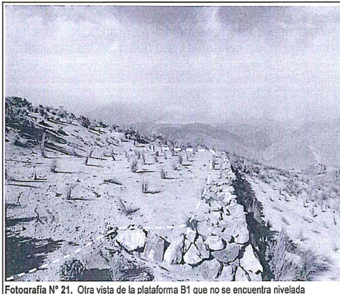
Fotografía N° 21. Otra vista de la plataforma B1 que no se encuentra nivelada
