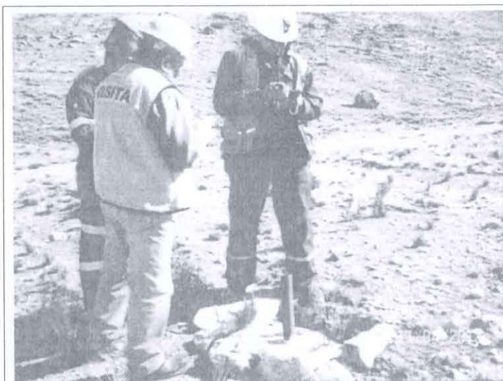
Foto N° 02: Hallazgo N° 02, En el sondaje DDH-01-07, Se observó que el hueco dejado por la perforación, esta descubierto.
