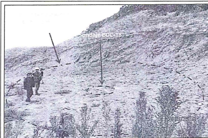
Fotografía N° 30.- La plataforma de perforación presentaba corte del terreno, remoción de suelo y rocas sueltas; asimismo, se verificó un sondaje con código BDC-18, que presentaba un bloque de concreto con una tubería de PVC. Falta perfilar y revegetar (Coordenadas UTM Datum geodésico WGS84: 9 094 911N 766 338E).
