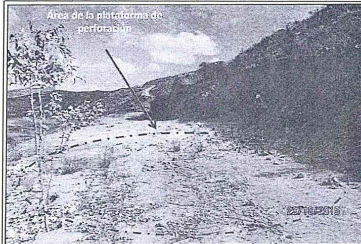
Fotografía N° 3.- La plataforma de perforación presentaba corte del terreno y remoción de suelo; asimismo, se observó deslizamiento de material proveniente del talud de corte. Plataforma de Perforación con código de sondaje BDC-22, falta perfilar y revegetar (Coordenadas UTM Datum geodésico WGS84: 9 095 185N 764 630E).
