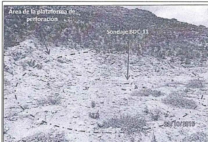
Fotografía N° 9.- La plataforma de perforación presentaba corte del terreno, remoción de suelo y rocas sueltas; asimismo, se verificó un sondaje con código BDC-11, que presentaba un bloque de concreto con una tubería de PVC. Falta perfilar y revegetar (Coordenadas UTM Datum geodésico WGS84: 9 092 580N 764 817E).
