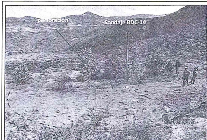
Fotografía N° 5.- La plataforma de perforación presentaba corte del terreno, remoción de suelo y rocas sueltas; asimismo, se verificó un sondaje con código BDC-14, que presentaba un bloque de concreto con una tubería de PVC. Falta perfilar y revegetar (Coordenadas UTM Datum geodésico WGS84: 9 094 946N 763 879E).
