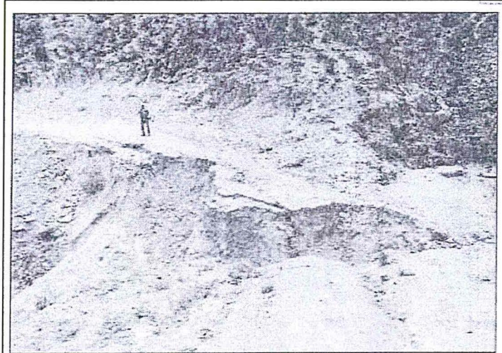
Fotografía N° 51.- Acceso a la plataforma de perforación con código de sondaje BDC-08 y BCD-08A, en el cual se observó presencia de cárcavas. Falta perfilar y revegetar.
