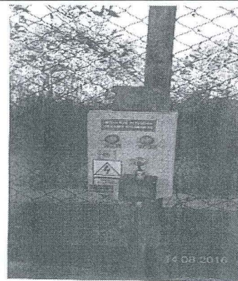
Fotografía N° 2.- Instalación del equipo fijo detector de gases y vapores combustibles con alarma audible dentro del almacén temporal de residuos peligrosos.
