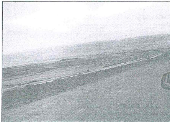
Fotografía N° 10. Se observa la tubería de transporte de relave posicionada directamente en el suelo sin ningún sistema de contención para capturar relaves ante posibles fugas.
