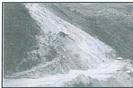
Fotografía N° 25. Tramo i+4: Talud inestable con pendiente mayor a 2:1 sin medida de estabilización
