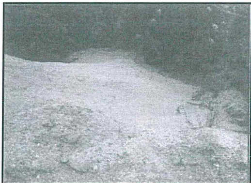
Fotografía N° 15. Tramo i: Material excedente lanzado hacia la quebrada eliminando la vegetación natural
