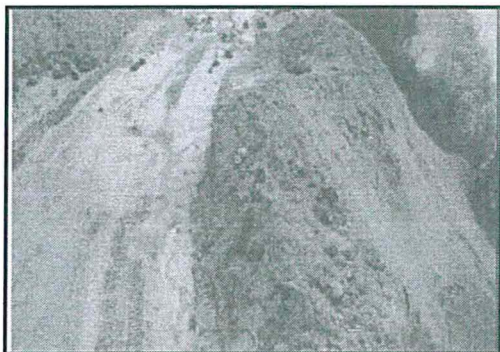
Fotografía N° 17. Tramo i+1: Material excedente depositado en el borde la carretera
