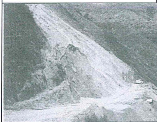
Fotografía N° 25. Tramo i+4: Talud inestable con pendiente mayor de 2:1 sin medida de estabilización
