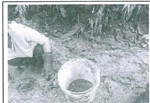
Foto N° 6: Muestra al personal contratado por la empresa JCA, realizando trabajos de limpieza, recuperación del área afectado por el derrame.
