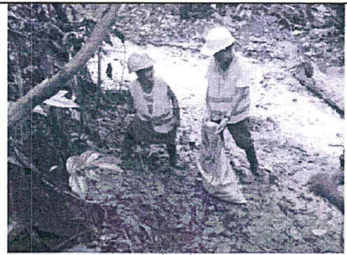
Foto N° 17: Muestra a trabajadores contratados por la empresa JCA realizando labores de limpieza y remediación del área impactada. Se observa iridiscencia de hidrocarburo, resaltamos que los trabajos se iniciaron hace 20 días
