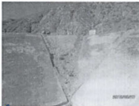
Otra vista del dique del área estanca, donde la erosión cumple su labor destructora en uno de sus ángulos.
