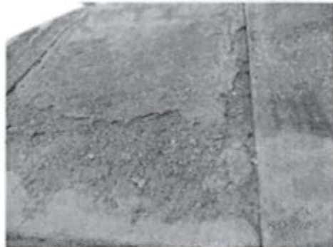
Vista de uno de los paños de concreto del dique de protección del tanque en proceso de deterioro por erosión.
