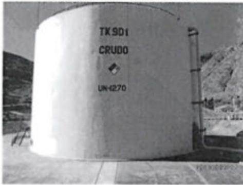
Fotografía N° 9: Tanque de Crudo TK 9D1
