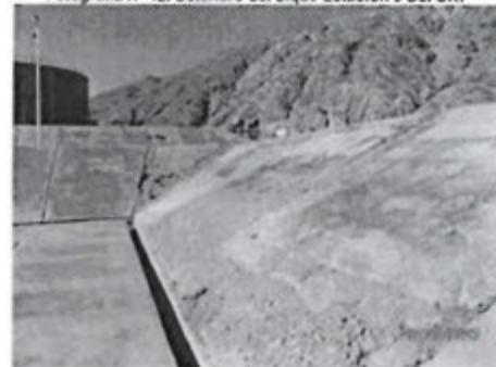
Fotografía N° 12: Deterioro del dique Estación 9 Del ONP
