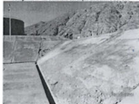
Fotografía N° 12: Deterioro del dique Estación 9 Del ONP
