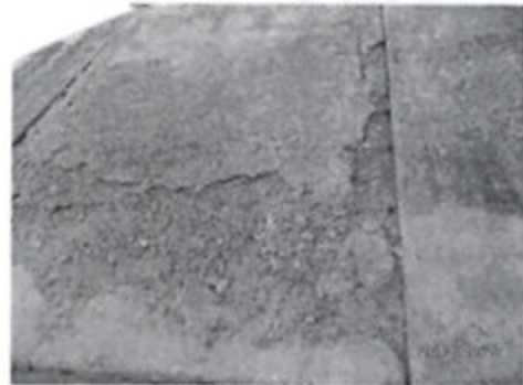
Fotografía N° 10: Deterioro de dique en Estación 9 del ONP.
