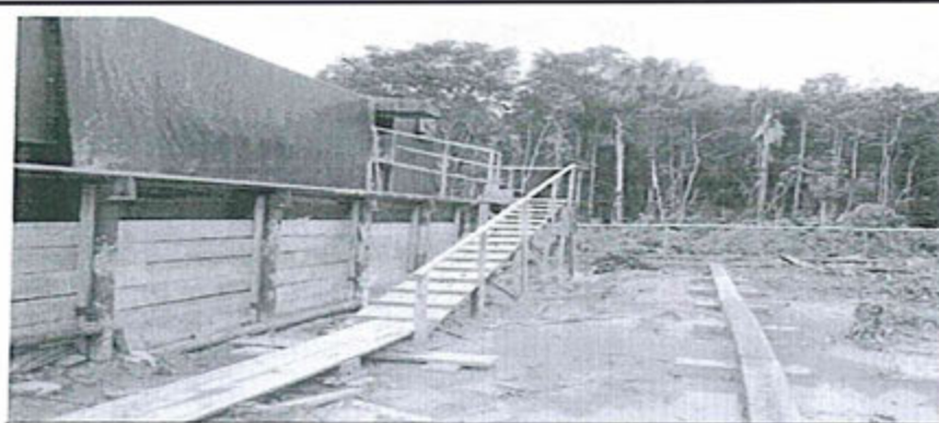
Foto N° 08: Se observa la parte derecha del área lateral (aprox. 14 m. x 6 m.) de la Poza 1502 impactada por el derrame de recortes y lodos de perforación.
