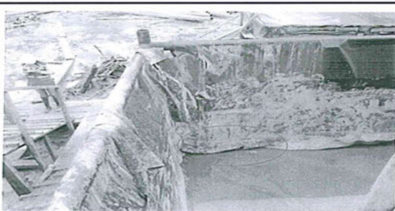
Foto N° 03: El sistema de contención de la Poza 1502, forrado con geomembrana de color negro. Vista panorámica desde el interior de la poza, donde se aprecia que pasó el sistema de contención, por alta presión produciendo el agujero y la rotura de geomembrana en la parte baja del dique de contingencia.
