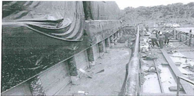
Foto N° 06: Se observa otra área estanque forrado con geomembrana aledaña a la Poza 1502, que sirvió para contener derrame de detritos de perforación. En el área de contingencia se observa contenido el material grueso sin recuperar y en la parte lateral de la Poza 1502, se observa charco con presencia de sólidos suspendidos de recortes y lodos de perforación.
