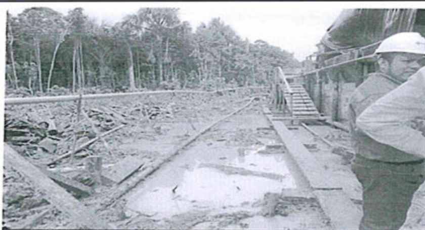
Foto N° 07: Se observa la parte frente del área lateral (aprox. 28 m. x 5 m.) de la Poza 1502 impactada por el derrame de recortes y lodos de perforación (migración de sólidos suspendidos).
