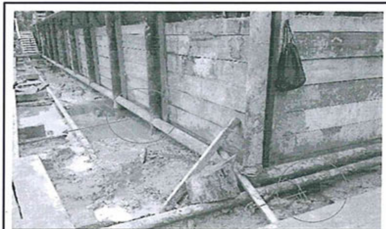
Foto N° 02: Se observa puntos de salida de recortes y lodos de perforación de la Poza 1502, por el colapsamiento de la poza mencionada poza.
