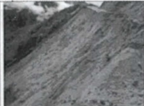
Fotografía N° 27. Tramo i+7. Material excedente lanzado hacia la quebrada eliminando la vegetación natural
