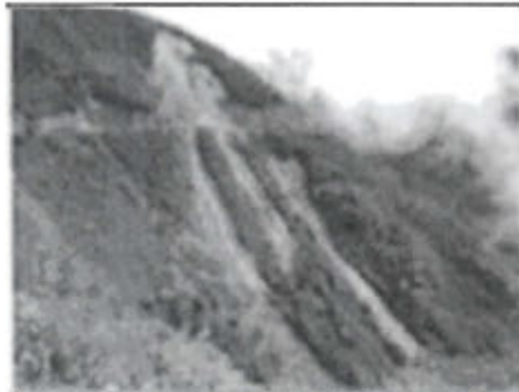
Fotografía N° 19. Tramo i+2 Talud inestable con pendiente mayor a 2:1 sin medida de estabilización
