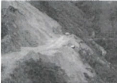
Fotografía N° 26. Tramo i+4. Material excedente depositado al borde la carretera
