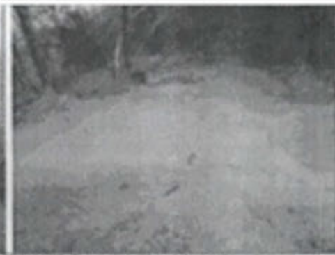
Fotografía N° 18. Tramo i+1: Material excedente lanzado hacia la quebrada eliminando la vegetación natural
