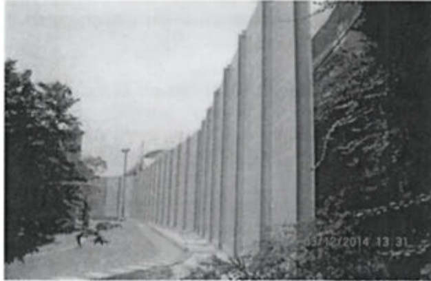
En el Informe N° 067-2014-OEFA/DS-ELE, la DS consignó que el administrado instaló una barrera acústica en la CT Santa Rosa.
