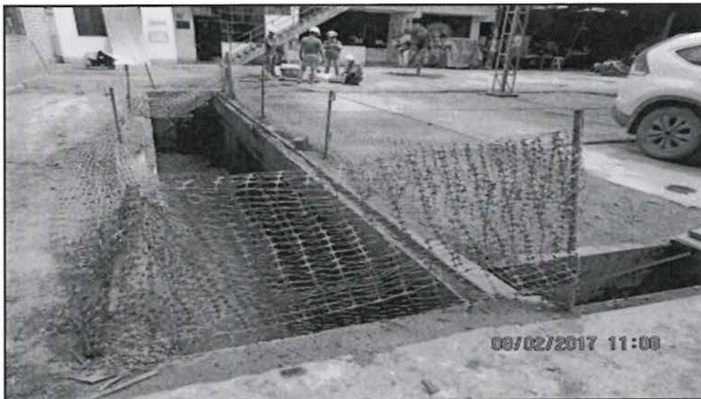
Foto N° 5: Poza de sedimentación de efluentes de la planta de destilería del administrado.
