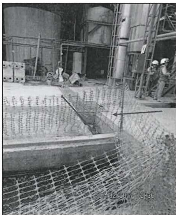
Foto N° 4: Circuito de conducción de los efluentes de la zona de producción de la planta de alcohol del administrado
