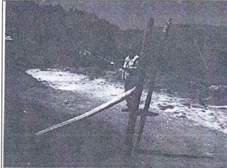
Fotografía N° 05 Hallazgo N° 05: El acceso a la plataforma PLMOD-15 no está remediado. Este tramo no rehabilitado esta entre la plataforma y el punto GPS 750011Este, 5218216Norte. Nota: El Supervisor esta tomando posición satelital punto GPS 750011Este, 5218216Norte, la flecha indica la ubicación de la plataforma PLMOD-15, la cual sale del lente de la cámara.
