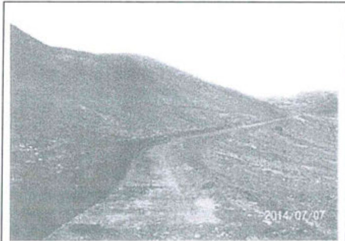
Foto N° 02: Cunetas habilitadas al borde de las vías
