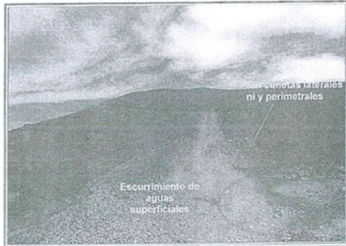
Fotografía N° 46: Vista Fotográfica de los accesos los cuales no cuentan con cunetas laterales y perimetrales en las áreas de las actividades de exploración así mismo no se evidencia badenes o drenes al escurrimiento de aguas superficiales. Hallazgo N° 8.
