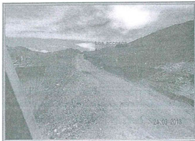
Fotografía N° 47: Vista Fotográfica de los accesos los cuales no cuentan con cunetas laterales y perimetrales en las áreas de las actividades de exploración así mismo no se evidencia badenes o drenes al escurrimiento de aguas superficiales. Hallazgo N° 8.
