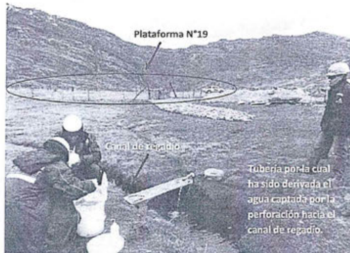
Foto N° 26: Estación PMA-03, corresponde a una descarga generada desde la plataforma N°19. A partir de la cual se deriva el agua subterránea captada por la perforación por medio de tuberías hacia un canal de riego. Esto evidencia la no obturación del sondaje.
