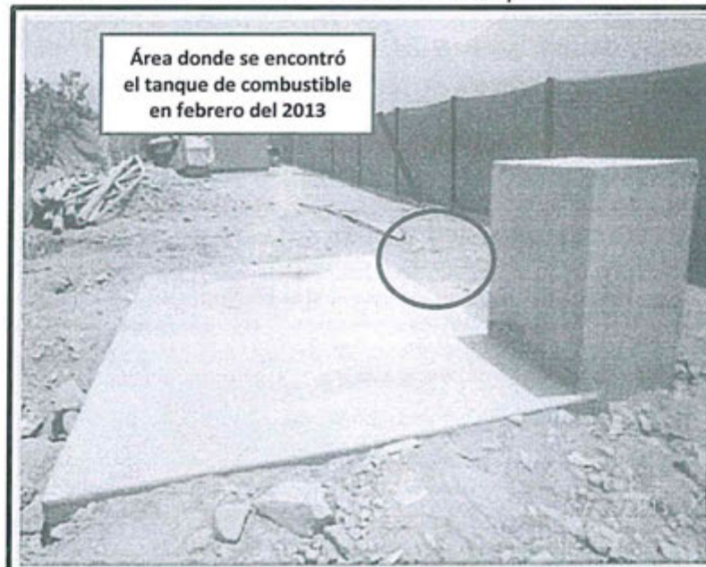
Situación observada el 17 de diciembre sin el tanque de combustible
