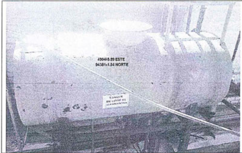
Tanque de Licor de Separadora o Tanque Coagulador N° 2 (Coordenadas UTM WGS 84: 490465.89E, 9438141.94N)
