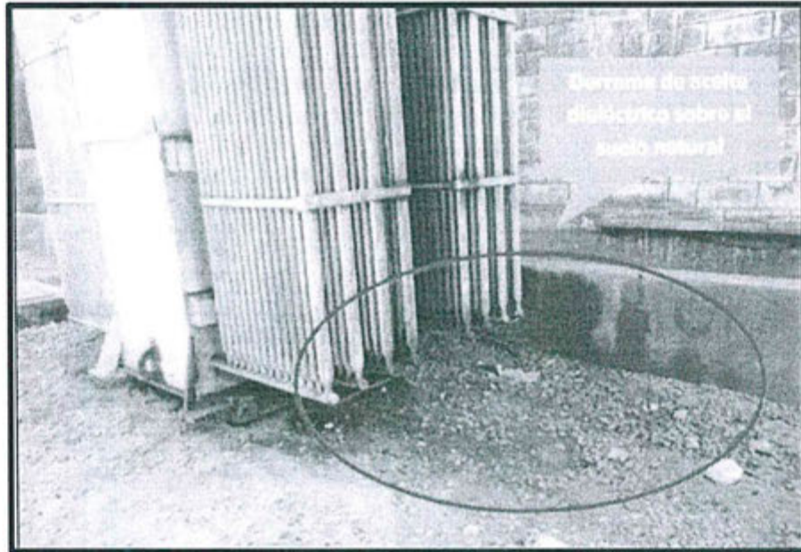
Fotografía N° 3. Vista del derrame de aceite sobre el suelo natural
