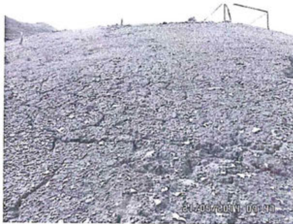
Fotografía N° 67: Talud oeste con grietas de la plataforma superior.
