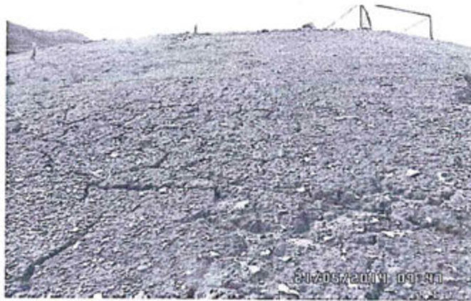
Fotografía N° 67: Talud oeste con grietas de la plataforma superior.
