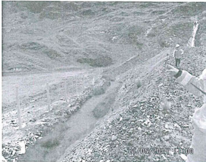
Fotografía N° 44: Canal de escorrentía construido en el pie del talud de la plataforma inferior, dentro del cual se ha observado vegetación y agua estancada.
