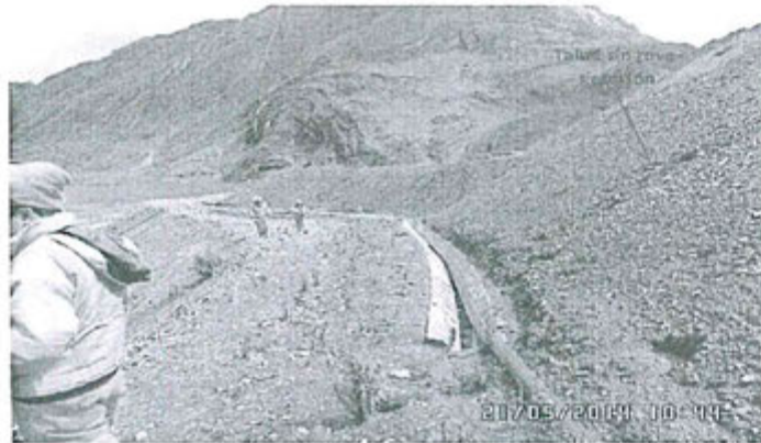
Fotografía N° 11: Talud sur de la plataforma superior del ADRC, no se encuentra revegetado.
