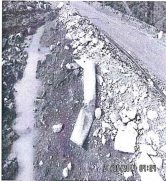
Fotografía N° 72: Residuo metálico sobre la plataforma superior.
