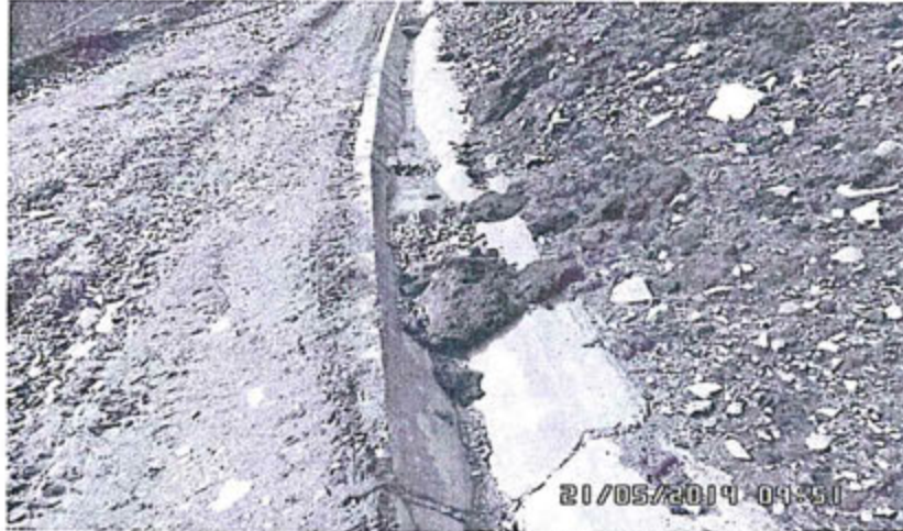
Fotografía N° 29: Canal de escorrentía construido en el pie del talud norte de la plataforma superior, se encuentra obstruida por sedimentos.
