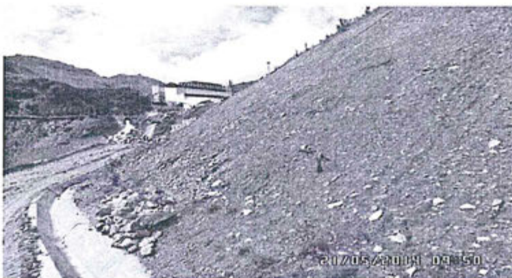
Fotografía N° 7: Talud del lado norte de la plataforma superior, en el pie de talud no se ha colocado geotubos.
