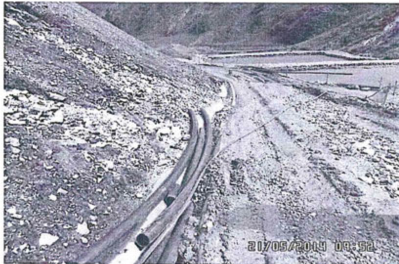
Fotografía N° 30: Canal de escorrentía construido en el pie del talud norte de la plataforma superior, se encuentra obstruida por sedimentos y tubería.
