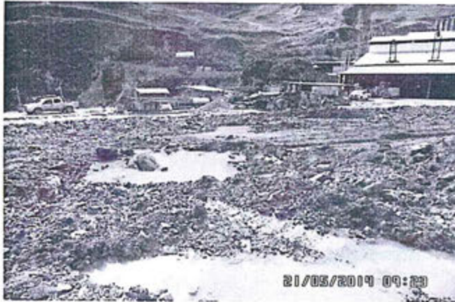
Fotografía N° 47: Plataforma superior donde se ha acumulado suelo orgánico y no se ha uniformizado. Se observa agua acumulada.
