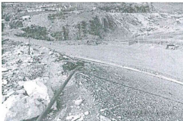
Fotografía N° 49: Lado sur de la plataforma superior no cubierta con arcilla y suelo vegetal. Se observa el tubo y manguera que es usada para el riego de la zona revegetada.
