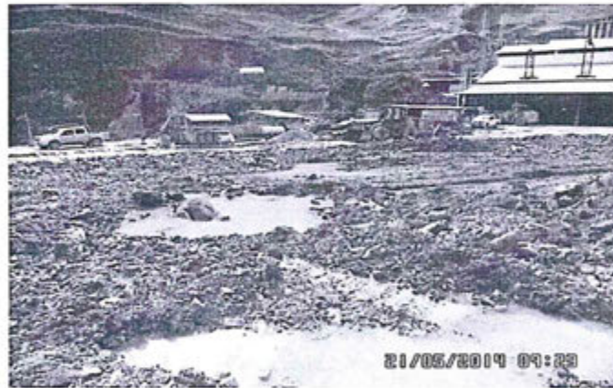
Fotografía N° 47: Plataforma superior donde se ha acumulado suelo orgánico y no se ha uniformizado. Se observa agua acumulada.
