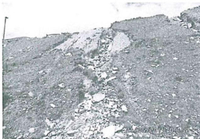
Fotografía N° 9: Talud norte de la plataforma superior, se encuentra erosionado.
