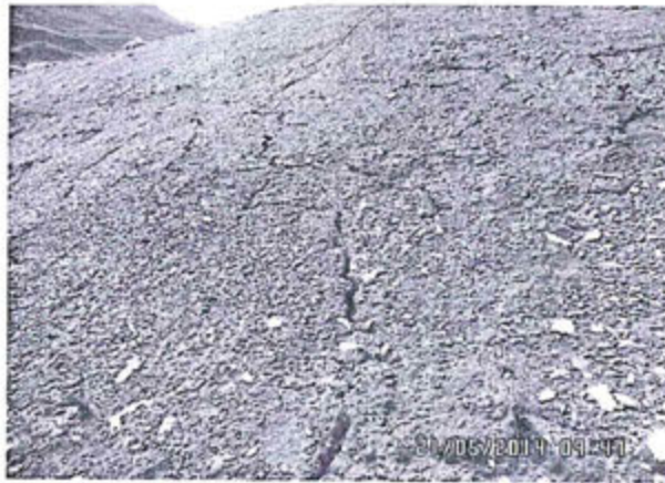
Fotografía N° 68: Talud oeste con grietas de la plataforma superior.
