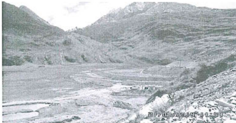
Fotografía N° 3: Antiguo Depósito de Relaves Contonga (ADRC), donde se observa la gradiente final del talud oeste.
