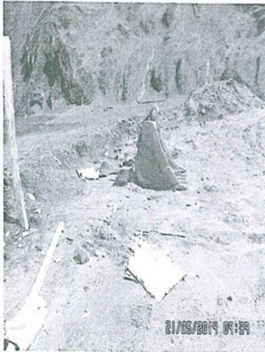
Fotografía N° 76: Residuos de cartón, madera, geomembrana y de metal al costado del acceso construido en el talud de la plataforma superior.
