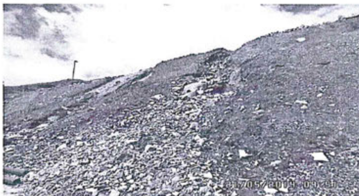
Fotografía N° 8: Talud norte de la plataforma superior, se encuentra erosionado.
