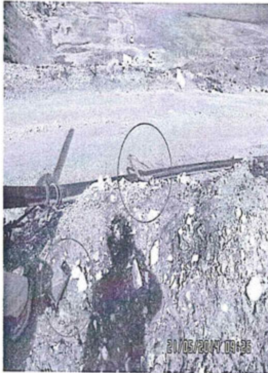
Fotografía N° 74: Residuos metálicos sobre la plataforma superior.
