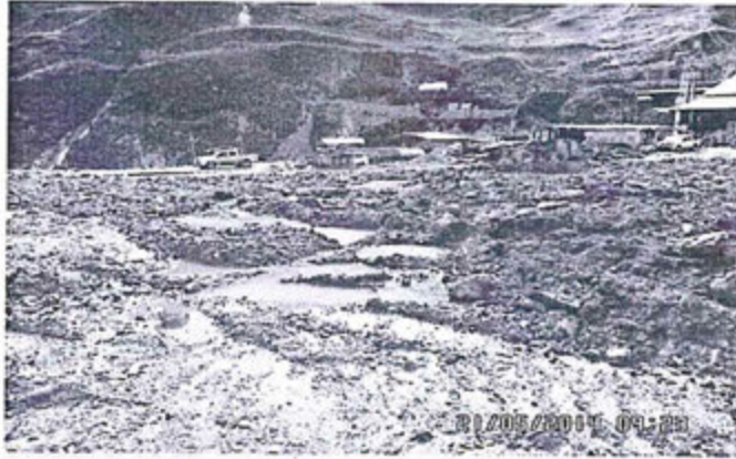
Fotografía N° 46: Plataforma superior donde se ha acumulado suelo orgánico y no se ha uniformizado. Se observa agua acumulada.
