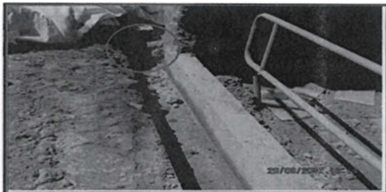
FOTOGRAFIA N° 53.- Vista del otro extremo del canal de concreto construido por el administrado, el cual no cuenta con un diseño ingenieril de derivación de agua de lluvia. Incumplimiento recomendación N° 1 - 2011.
