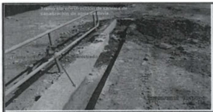
FOTOGRAFIA N° 52.- Vista de la canaleta de concreto construida en parte del frontis del área techada, el cual presenta restos de tierra en su interior, ubicado al costado de la tolva de gruesos de la planta concentradora. Incumplimiento recomendación N° 1 - 2011.
