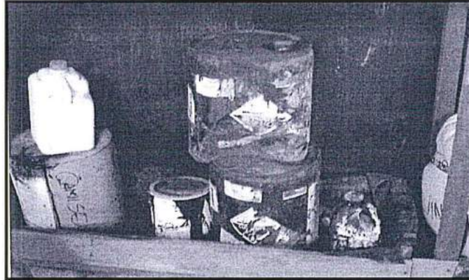
Fotografía N° 8: Envases deteriorados con productos sin identificación y sin rombo NFPA en el almacén de productos químicos.
