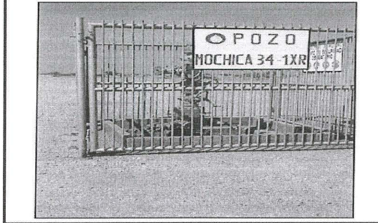
Fotografía N° 2: Pozo Mochica 1X con cabezal y enrejado perimétrico.
