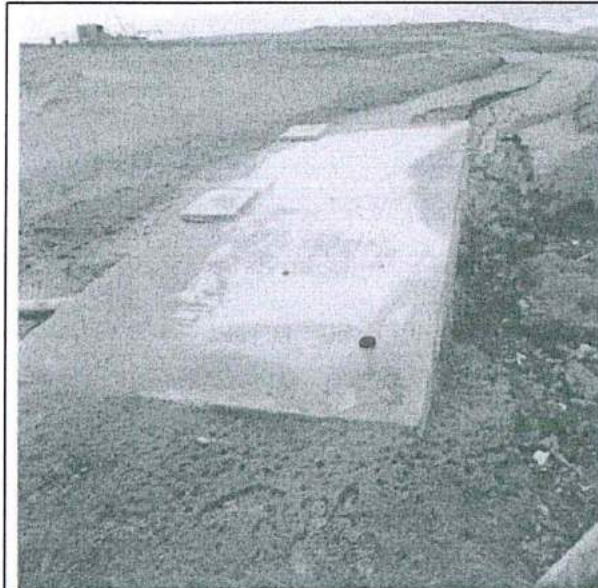
Foto 31. Pozo de almacenamiento de efluentes domésticos (pozo séptico y pozo de percolación).
