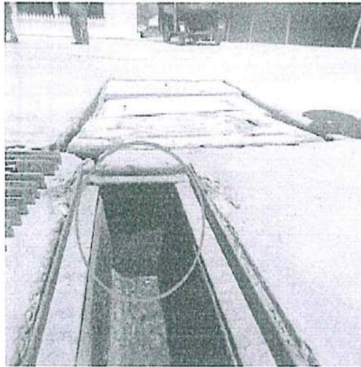
Foto N° 23 -Rejilla vertical ubicada antes que el efluente ingrese a la poza de sedimentación.
