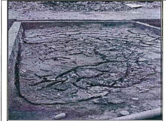
Foto N° 17: Lodos de sedimentación de tratamiento de efluente industrial de proceso de curtido de pieles (residuo peligroso), acumulados a la intemperie sobre el terreno de la planta, sin ubicación definida, ni acondicionamiento adecuado.
