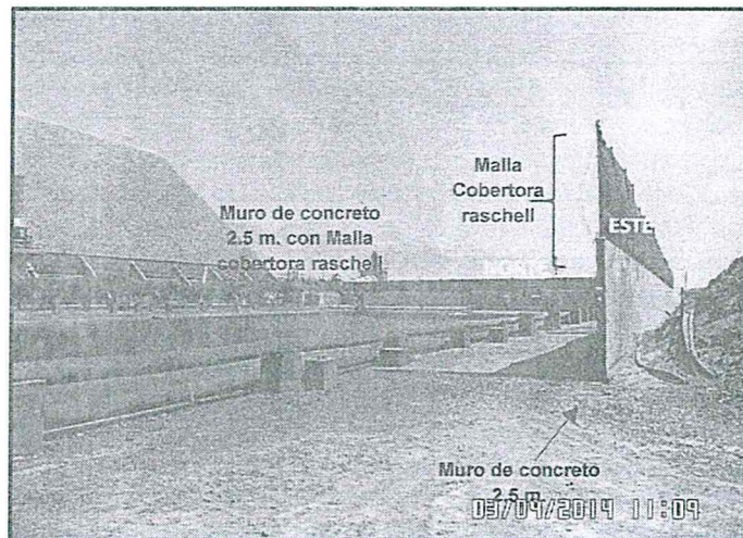
Fotografía N° 42 del Informe de Supervisión: Vista de muro de concreto con malla de contención en el lado Norte y Este de la poza de efluentes, no cuenta con malla cobertora. Consignado en el Hallazgo N° 1. Ubicado en las coordenadas UTM WGS 84: N 8 882 071, E 809 307.
