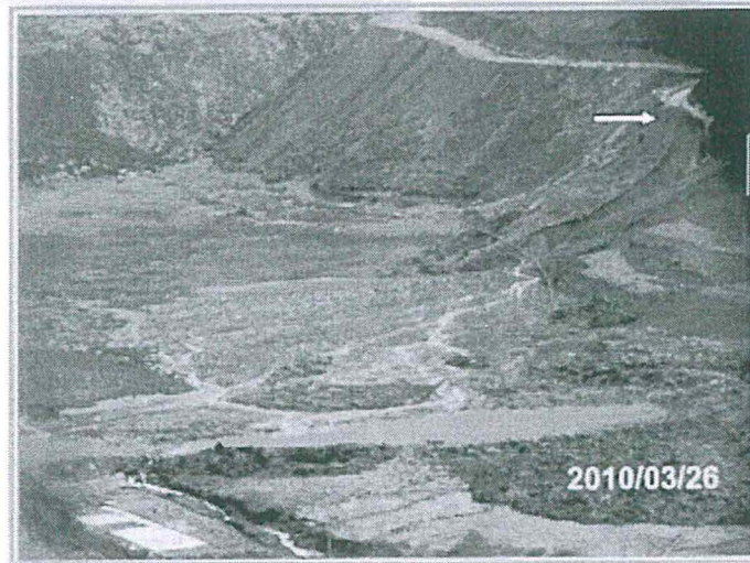
Fotografía N° 30: Canal de coronación en la margen izquierda de la quebrada Rumiallana, el cual ha colapsado y las aguas han erosionado la ladera impactando el bofedal ubicado en el lecho de la quebrada, UEA Cerro de Pasco.
