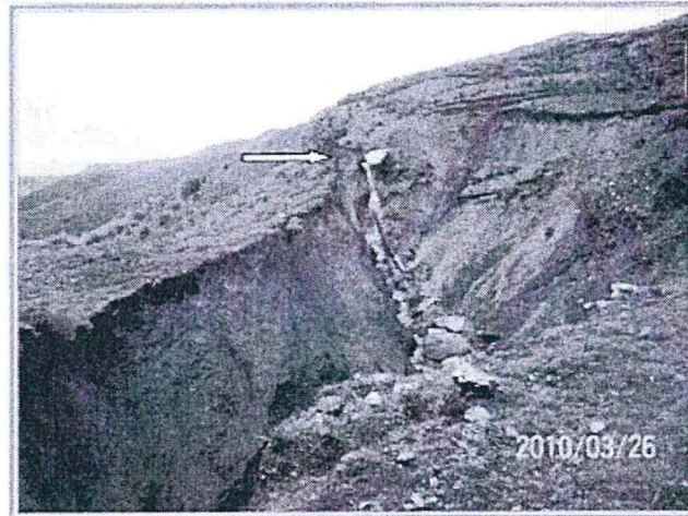
Fotografía N° 32 Canal de coronación en la margen izquierda de la quebrada Rumiallana, el cual ha colapsado y las aguas han erosionado la ladera impactando el bofedal ubicado en el lecho de la quebrada (viene fotografía N° 31), UEA Cerro de Pasco.
