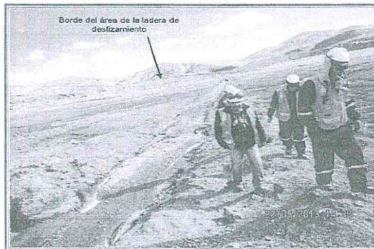
Fotografía N° 109: Hallazgo N° 1. En la parte central del bofedal, el canal de derivación de la escorrentía colectada de la parte, se encuentra con carga de sedimentos. Al fondo el borde del área de deslizamiento de la ladera Oeste del Cerro Jollone.
