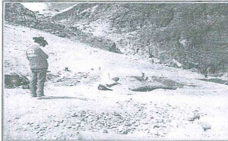
Fotografía N° 39: Hallazgo N° 4 y 5. Sistema de Tratamiento de agua ácida del Tajo y Botadero Jessica. Vista fotográfica de la construcción de las pozas del sistema Wetland.
