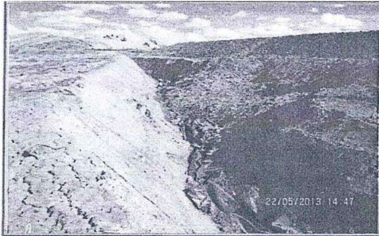
Fotografía N° 110: Hallazgo N° 1. Para la derivación de la escorrentía se construyó este canal perimetral en el sector Oeste del Bofedal. Se ha producido un impacto al bofedal, paisaje, suelo y vegetación del área circundante.
