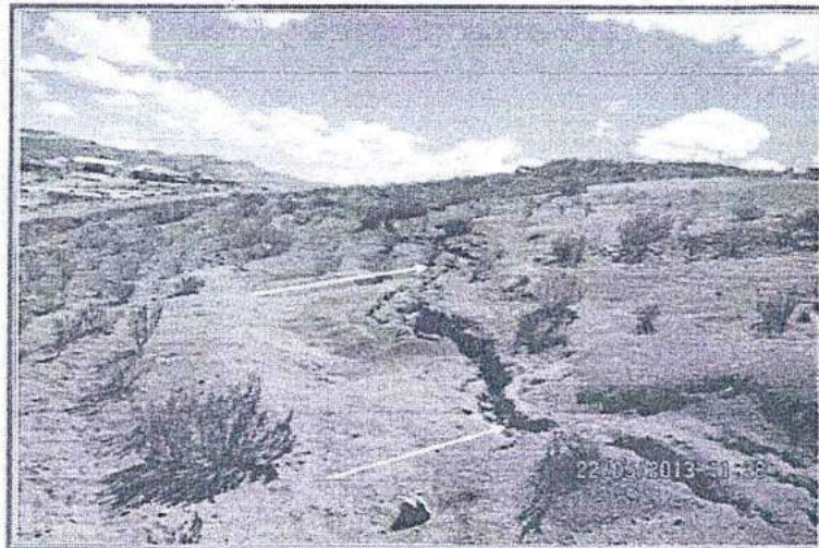
Fotografía N° 121: Observación N° 1. Las grietas se extienden hacia las proximidades de las Pozas PLSVLS, eventos mayores de la Planta de Procesos Andrés.
