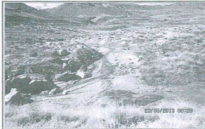
Fotografía N° 71: Hallazgo N° 3. Botadero de Desmonte N° 1. La escorrentía colectada en el canal de coronación es derivada a esta ladera. No se constató la existencia de la rápida ni las pozas para la retención de los sólidos arrastrados. El paisaje y vegetación se encuentra impactada.
