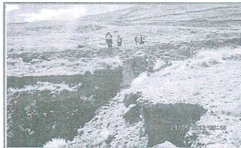
Fotografía N° 74: Hallazgo N° 3. Botadero de Desmonte N° 1. La escorrentía colectada en el canal de coronación, finalmente es derivada al río Chacapalca. No se construyó la estructura de entrega revestida con rip rap. En la vista fotográfica los funcionarios del titular minero.
