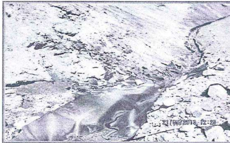
Fotografía N° 53: Hallazgo N° 6. Canal de coronación del PAD de Lixiviación Jessica. Se constató que en el canal de coronación, en varios tramos, la geomembrana que impermeabiliza la base y costado, no se encuentra debidamente anclada.
