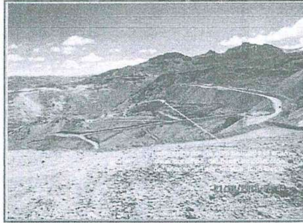
Fotografía N° 18: Vista de la ladera de la quebrada Azufrini, a donde será derivada el agua de escorrentía de la vía de acceso al tajo Jessica. Se encuentra en proceso de construcción el canal de derivación y pozas de sedimentación, donde se hará el monitoreo de las aguas para determinar el requerimiento de tratamiento en caso tenga un pH ácido.
