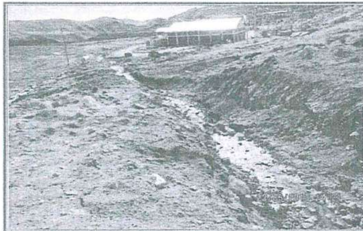
Fotografía N° 108: Hallazgo N° 1. Las escorrentías por medio de este canal de derivación sin revestimiento, es derivada ladera abajo hasta llegar al canal de coronación del bofedal que esta al costado del área de deslizamiento recurrente (Ladera Oeste cerro Jollone).
