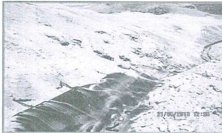
Fotografía N° 178: Levantamiento recomendación N° 4. El PAD de Lixiviación Jessica cuenta con canal de coronación impermeabilizada con geomembrana que está asegurada con tiras hacia estacas ubicadas a los costados del canal. En varios tramos, la geomembrana se cayó de los seguros y no cumple su objetivo.
