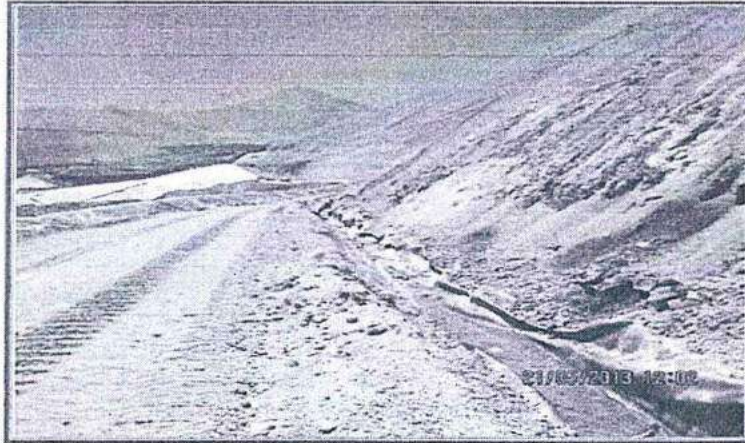
Fotografía N° 52: Hallazgo N° 6. Canal de coronación del PAD de Lixiviación Jessica. Se constató que en el canal de coronación, en varios tramos, la geomembrana que impermeabiliza la base y costado, no se encuentra debidamente anclada.
