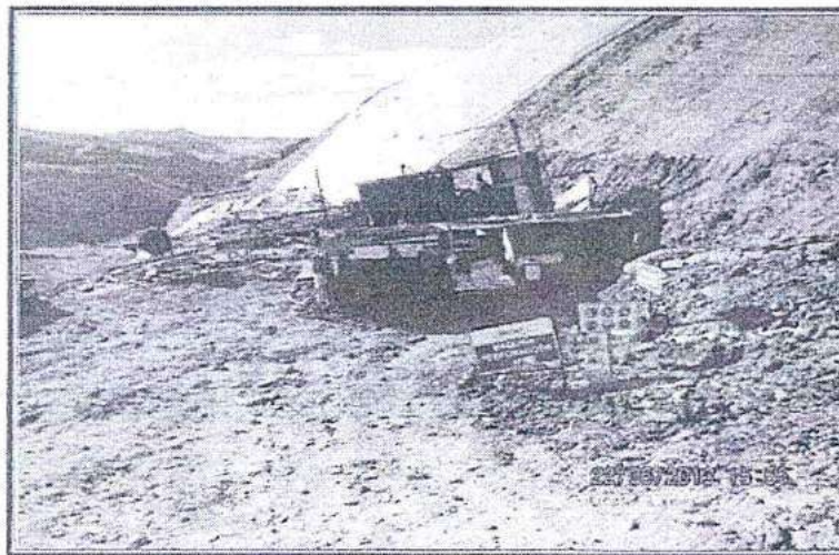
Fotografía N° 168: Zona de Deslizamiento, Ladera Oeste del Cerro Jollione. Se constató que en la zona de deslizamiento, se realiza la perforación de un taladro diamantino con la finalidad de drenar el agua acumulada
