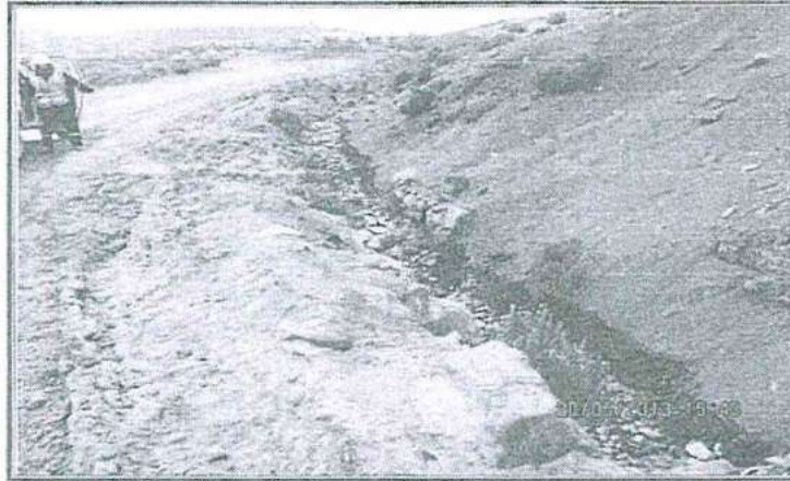
Fotografía N° 106: Hallazgo N° 1. Aguas abajo del PAD de Lixiviación Arasi, los canales de coronación de las vías de acceso a la Planta de Beneficio Arasi, se encuentran sin revestimiento.
