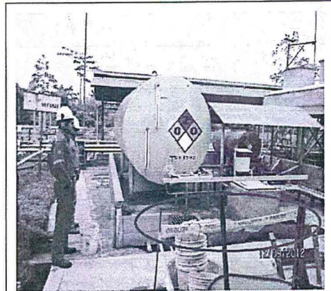
Foto N° 3: Muestra el tanque diario de diesel desde donde se alimenta de combustible al GE - 145, se observa también el muro de contención en proceso de refracción; el área estanca no cumple con la normativa.
