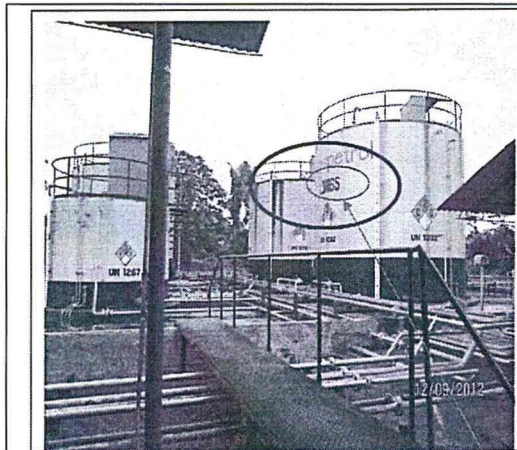
Foto N° 2: Muestra el Tanque de almacenamiento de Diesel 1.3M6S, desde donde se transfiere el diesel al tanque diario del Grupo Electrógeno N° 145 de Central Eléctrica.
