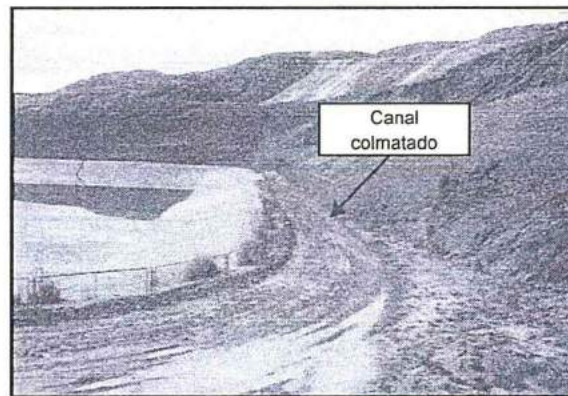
Fotografía N° 19 del Informe de Supervisión: Estructuras hidráulicas de la poza de grandes eventos del Pad N° 23, se encuentran colmatadas, generando el estancamiento de las aguas de escorrentías.
