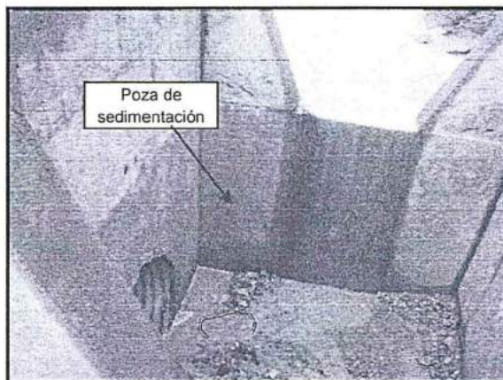
Fotografía N° 5 del Informe de Supervisión: Poza de sedimentación del canal de coronación de escorrentías del depósito de desmonte N° 9.
