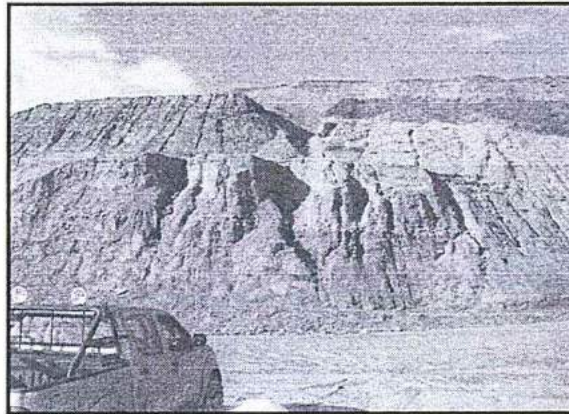
Fotografía N° 8 del Informe de Supervisión: Depósito de desmonte N° 8, ubicado frente al mirador del tajo Sacalla, presenta erosión sobre el talud y deslizamiento de material sobre el canal de coronación.
