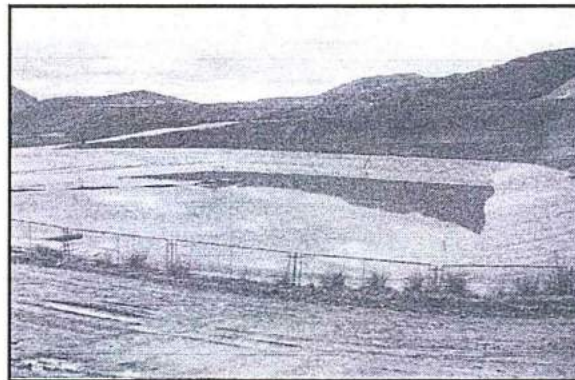
Fotografía N° 25 del Informe de Supervisión: Poza de grandes eventos N° 18 del pad N° 14, no cuenta con estructuras hidráulicas de coronación, generando el empozamiento de las aguas de lluvias en el entorno.
