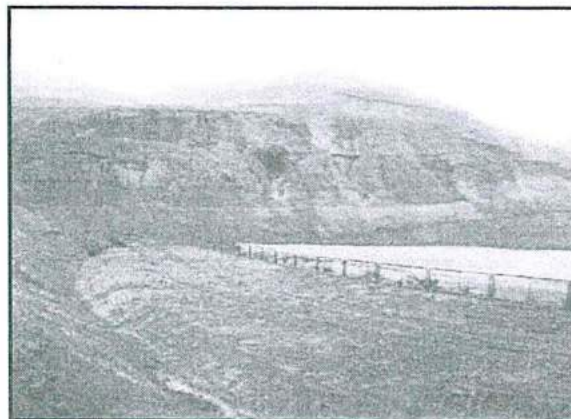
Fotografía N° 12: Perfilado y construcción de los canales de coronación de la Poza N° 18.
