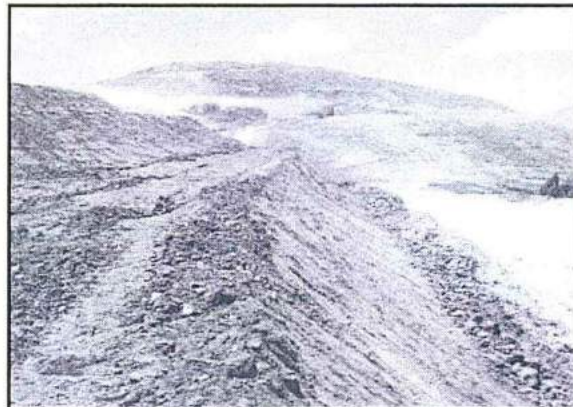
Fotografía N° 3: Detalle de banqueteo del botadero de Top Soil y la berma para evitar pérdida de material.
