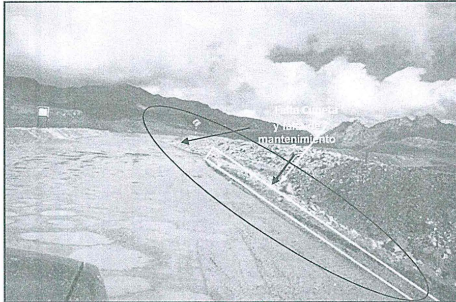
Fotografía HZ-02.- En las vías de acceso falta completar la construcción de cunetas para la captación de aguas de escorrentía, además de no haberse realizado el mantenimiento de las mismas.
