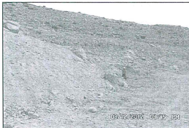
Fotografía N° 86 del Informe de Supervisión.- Se ha observado que el relleno de residuos domésticos no considera todos los criterios de diseño establecidos en la reglamentación de residuos domésticos.
