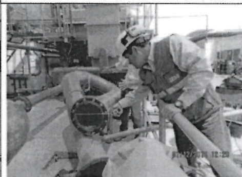
Foto 09 – Toma de medida del diámetro (16" pulgadas) de la tubería de vertimiento donde se realizó el bloqueo.
