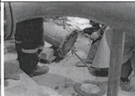
Foto 11 – Tubería de vertimiento bloqueada con una plancha metálica soldada a la tubería de vertimiento.
