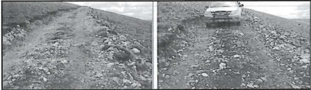
Vista 21. Trocha de acceso abierta con excesivo e innecesario movimiento de tierra. Vista 22. Inestabilidad y riesgo de erosión del suelo por la construcción de la trocha.
