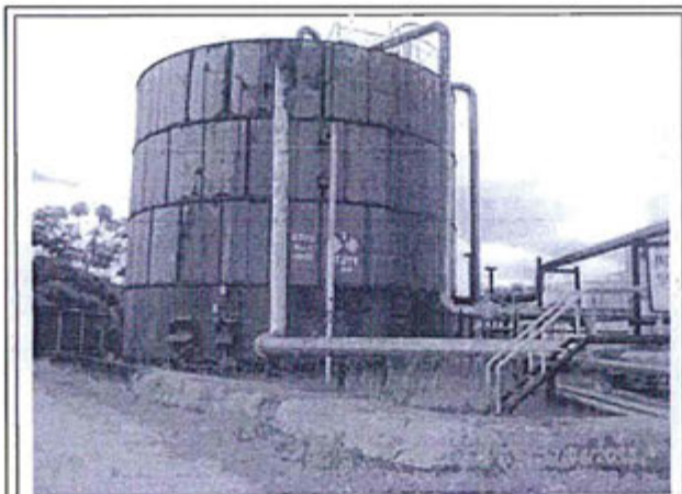
Fotografía N° 2: Zona estancia de tanque de crudo no presenta base impermeabilizada – Batería – Capahuari Sur – Lote 1AB.
