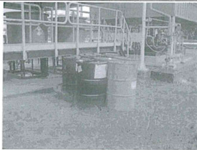
Fotografía N° 11: 07 recipientes (de 42 gal. de cap.) 05 con desmulsificante y 02 con lubricante sin sistema de contención secundaria – TapingPlant – Huayuri.
