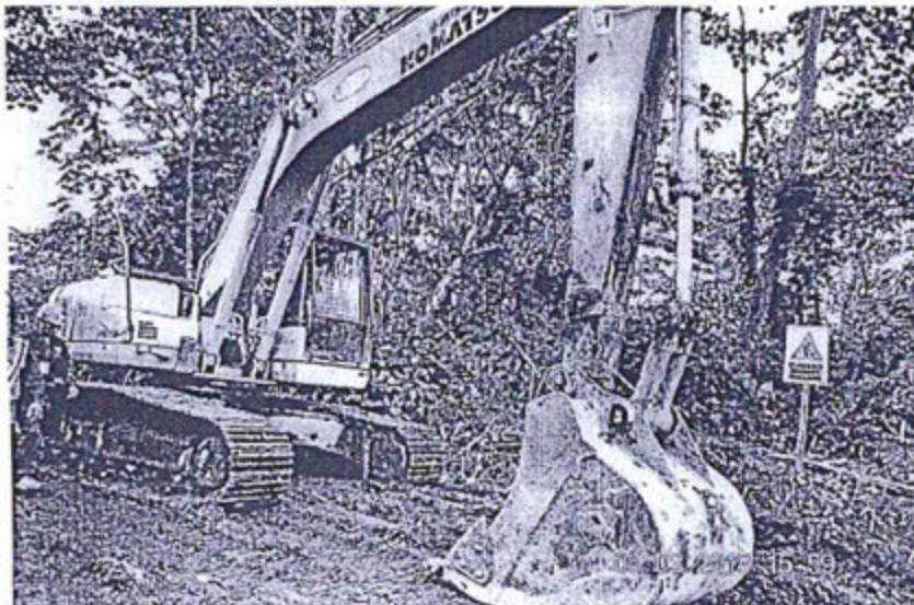
Fotografía 10 (a): El día martes 05-Mar-2013, se encontró a los trabajadores de Corpesa realizando las labores encomendadas por Pluspetrol Norte (según declaraciones del jefe de obras). Estas labores consisten en remover el suelo impactado y "ciliar" el granalote. Se evidenció la presencia de arena sobre el suelo removido.
