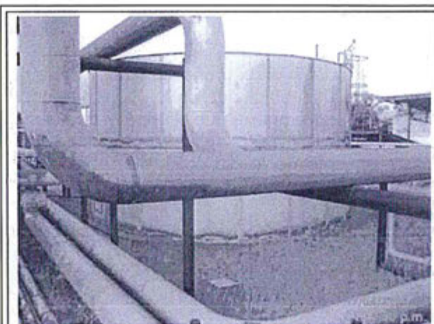
Fotografía N° 3: Zona estancia de tanque de diesel no presenta base impermeabilizada – Batería – Capahuari Sur – Lote 1AB.
