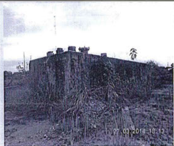
FOTO N° 290: E0403771 N9744348 / Instalación abandonada en área donde funcionó Ex Upper Pit pozos San Jacinto 18 y San Jacinto 19
