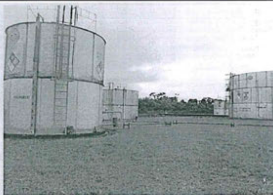
FOTO N° 274: E338477 N9689563 (PSAD 56) / Patio de tanques de combustibles - Andoas.
