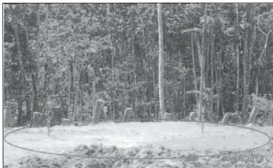
Fotografía N° 4: (...). No se ha construido los canales de drenaje para la recolección de agua de lluvia en la zona de celdas. Locación de Perforación Mapi LX.
