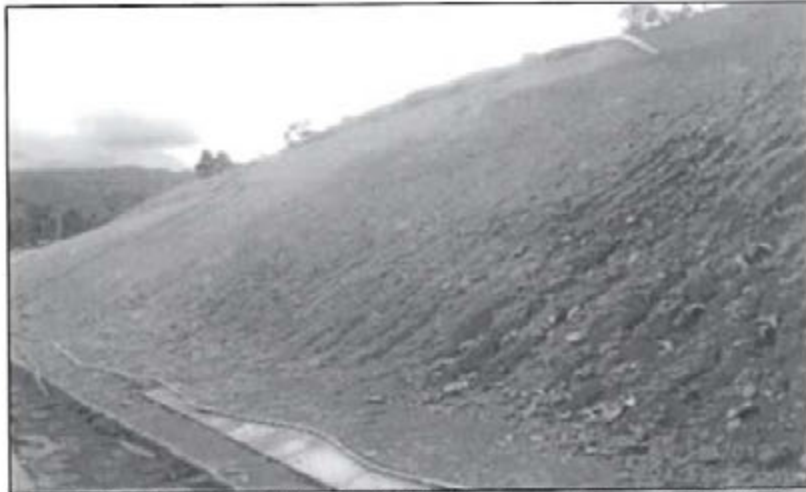
Fotografía N° 15: Lateral derecho del talud donde se observa la presencia de erosión por surcos ocasionados por lluvias. Locación de Perforación Mapi LX.
