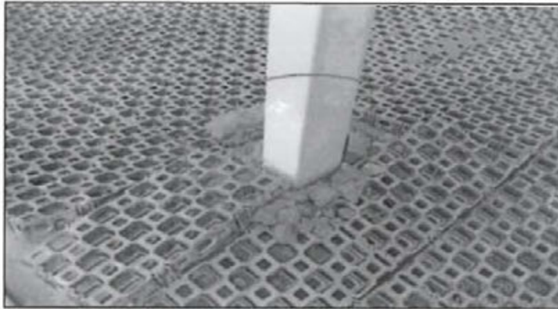
Fotografía N° 6: Rotura de geomembrana en la base de columna N° 1, se observa exposición de suelo, Locación Perforación Mapi LX.
