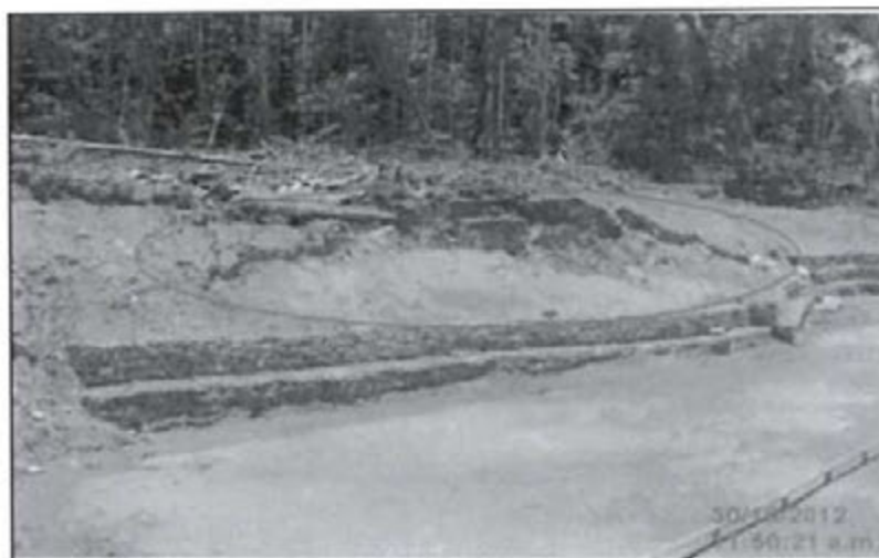
Fotografía N° 19: Desmoronamiento de talud, Helipuerto. Locación de Perforación Mapi LX.
