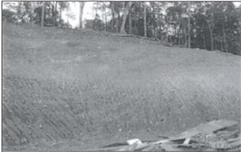
Fotografía N° 17: Lateral izquierdo del talud donde se observa la presencia de erosión por surcos ocasionados por lluvias. Locación de Perforación Mapi LX.
