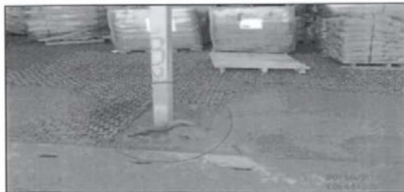
Fotografía N° 10: Rotura de geomembrana en la base de columna N° 5, se observa exposición de suelo, Locación Perforación Mapi LX
