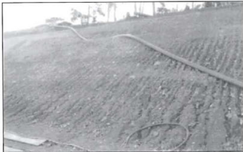
Fotografía N° 16: Lado centro de talud donde se observa la presencia de erosión por surcos ocasionados por lluvias. Locación de Perforación Mapi LX.
