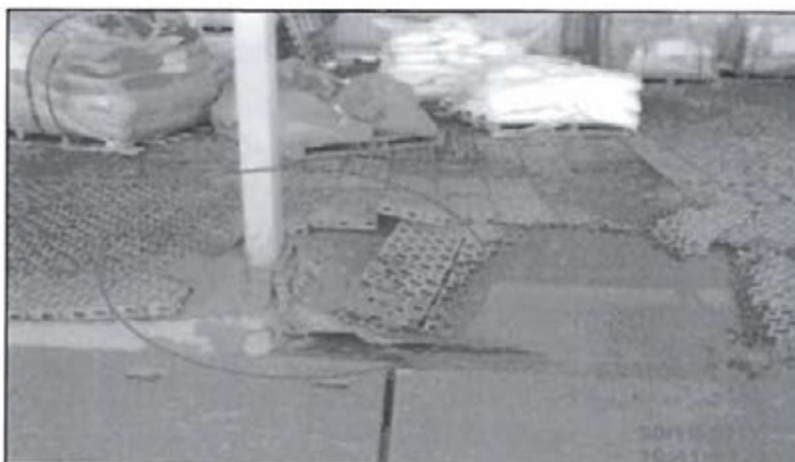
Fotografía N° 12: Rotura de geomembrana en la base de columna N° 7, se observa exposición de suelo. Locación Perforación Mapi LX
