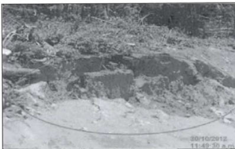
Fotografía N° 20: Vista ampliada de desmoronamiento de talud. Locación de Perforación Mapi LX.
