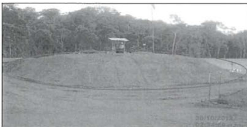
Fotografía N° 27: Primer montículo de topsoil no cubierto, que lo protege de la erosión ocasionada por la lluvia. – Locación de perforación Mashira GX.
