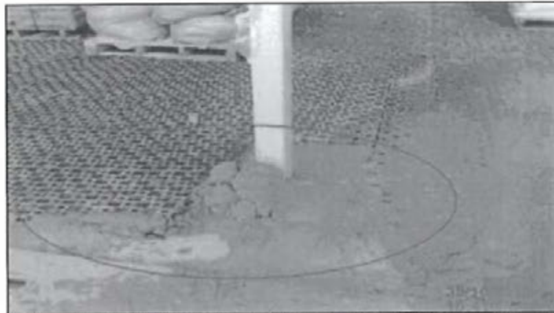
Fotografía N° 9: Rotura de geomembrana en la base de columna N° 4, se observa exposición de suelo, Locación Perforación Mapi LX
