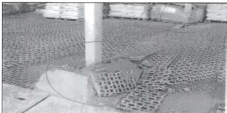
Fotografía N° 8: Rotura de geomembrana en la base de columna N° 3, se observa exposición de suelo, Locación Perforación Mapi LX
