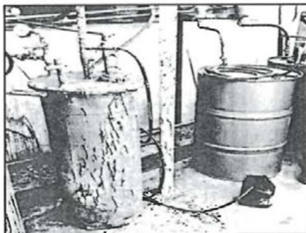
Foto N° 1: Sistema de pintado de cilindros de 45Kgr. En la foto se muestra el sistema usado para el pintado de 45Kgr. donde ocurrió el incidente. En la foto se recrea la conexión inadecuada desde el sistema usado para el pintado de cilindros, además de la manguera por la cual se liberó la pintura, que ocasionó el incidente.
